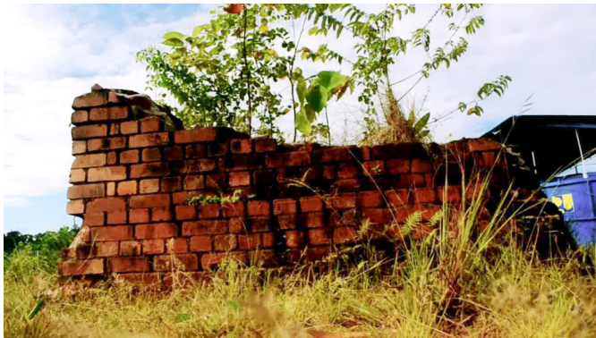
Eks Bangunan bersejarah zaman Belanda di Sukadana yang rusak, bahkan areal sekitar di jadikan penampungan air.
